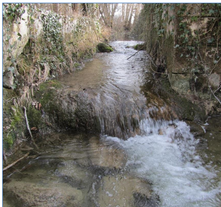
Obstacle à la CE (env. 35 cm) limitant les possibilités de colonisation piscicole via la Dronne Cf. état des lieux de la masse Dronne (FRFR2)
