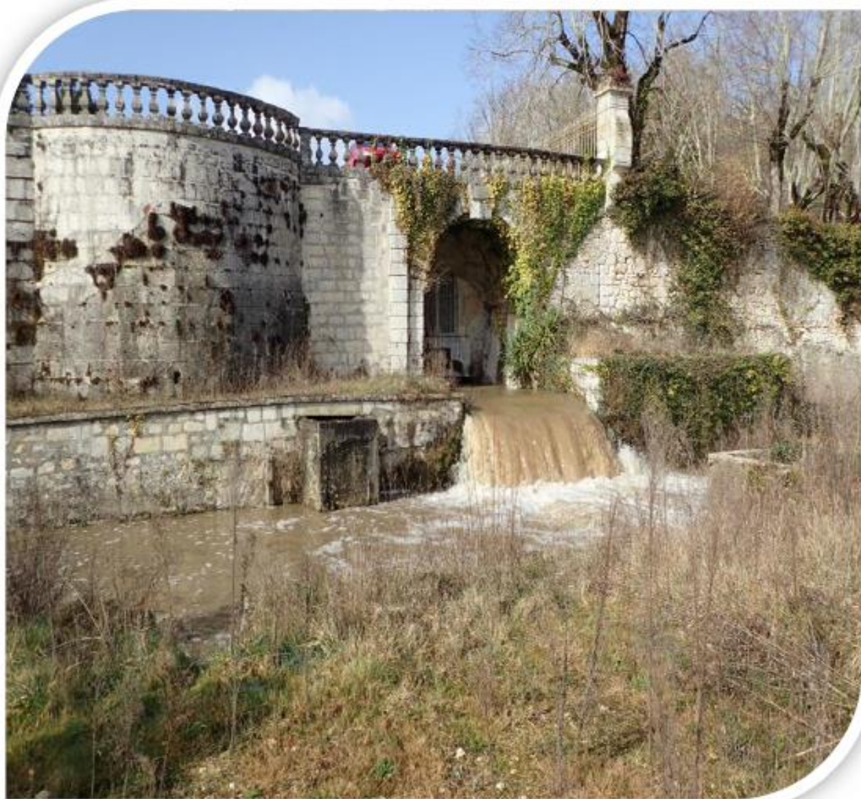
Ouvrage infranchissable au niveau de la confluence entre la Manore et la Lizonne (Château de la Rochebeaucourt), rendant tout échange biologique impossible entre les deux cours d'eau
