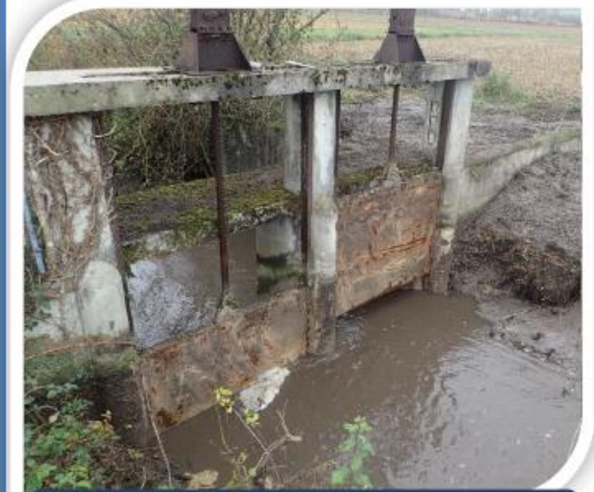
Vannage non géré impactant fortement la continuité piscicole et sédimentaire (Château du Bourbet)
