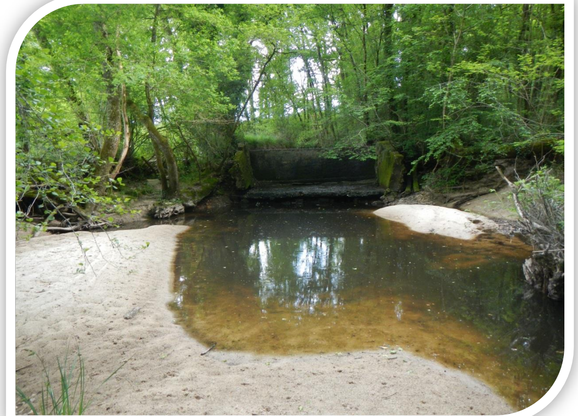
Seuil de répartition du moulin du Chalaure – le site de moulin (33) constitue un obstacle significatif à la continuité écologique
