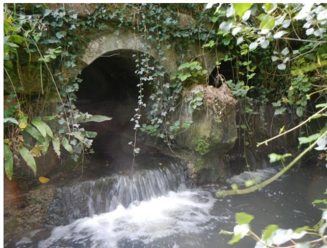
Photo 1 : Fosse de dissipation en aval du pont entraînant une chute d'eau, défavorable à la continuité écologique
