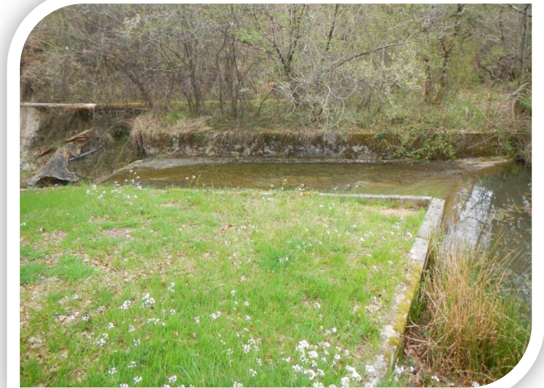
Déversoir de l'étang de la Latière – Problème continuité écologique (sédimentaire et piscicole)
