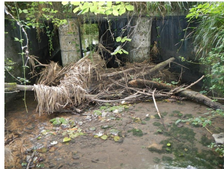
Photo 2 : Embâcles récurrents sur des secteurs de ponts et autres ouvrages pouvant à terme, pénaliser la continuité écologique
