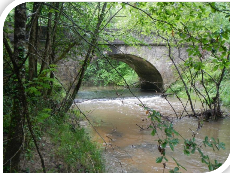
Seuil non franchissable pour les petites espèces piscicoles sous le pont de la D105
