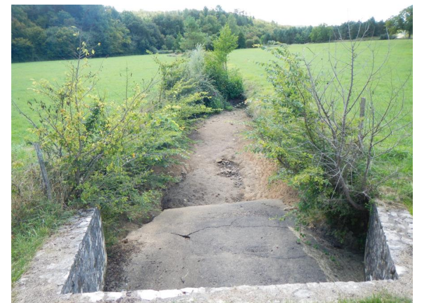
Photo 4 : Erosion en aval d'un pont avec forte instabilité. Gabarit homogène du lit
