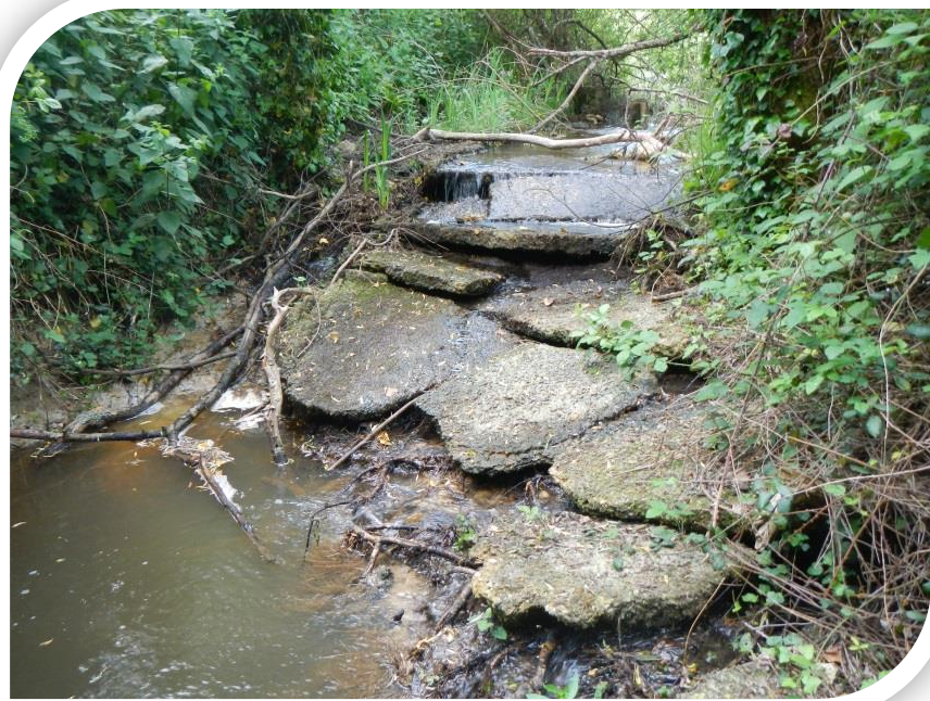
Seuil en ruine, à la sortie de l'étang à la « Jamette ». Impact continuité piscicole
