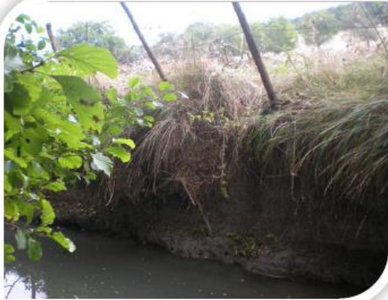
Portion avec des berges abruptes et instables, phénomène d'incision important
